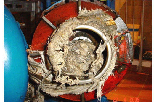
Verfilzte Feuchttücher. Regelmäßig legen sie Abwassersystem lahm.
